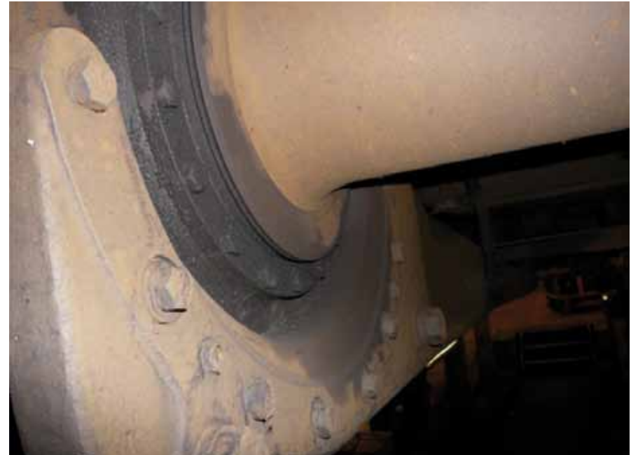
B20 ÜG_ROHR DICHT_Undichtigkeit am Getriebe_2
