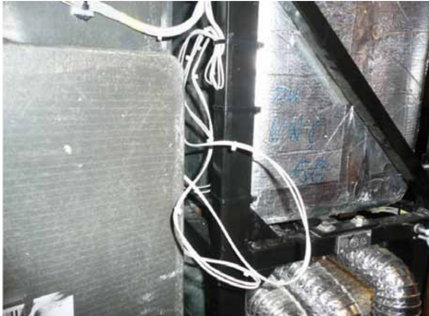
B13 ÜG _ KABELVERLEGUNG _mangelhafte Leitungsbefestigung
